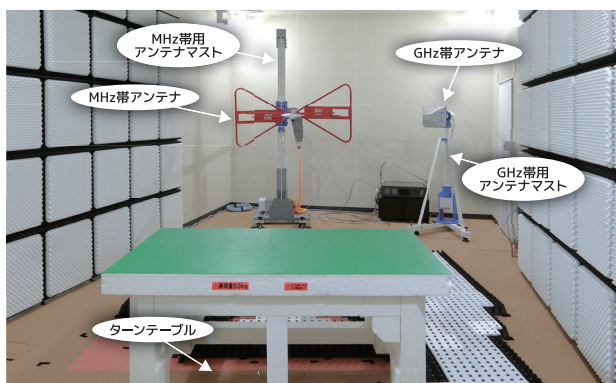
写真7 改修後の小型6面電波暗室
