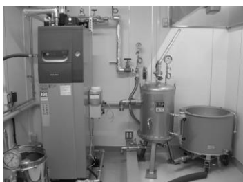
蒸米製造施設
